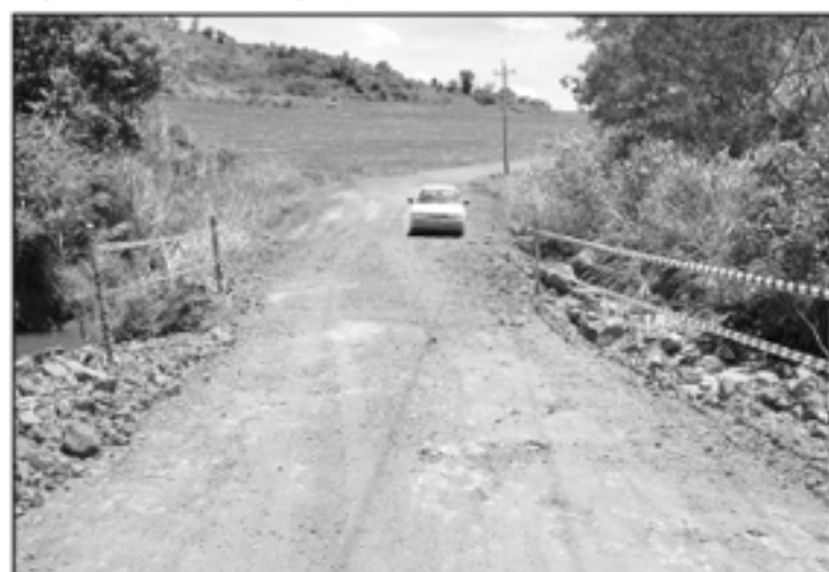
Diversos trechos foram danificados e estão sendo recuperados
