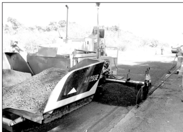
Obras de manutenção do DER também passam por outras rodovias da região
