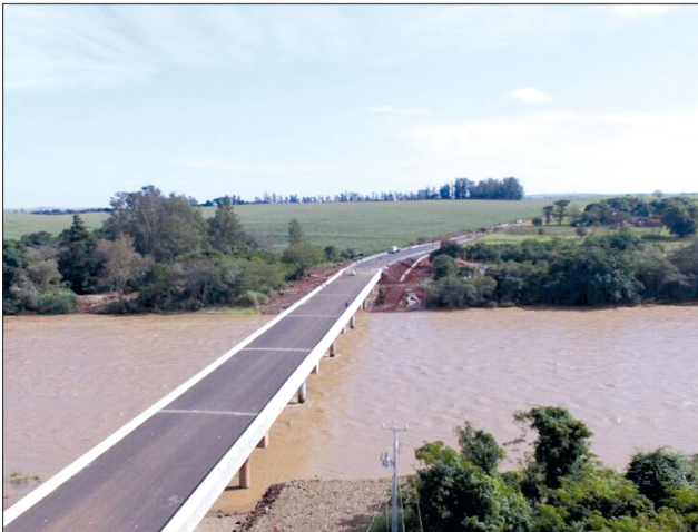
Ponte sobre o Rio das Cinzas foi reconstruída com investimentos do Governo do Paraná
